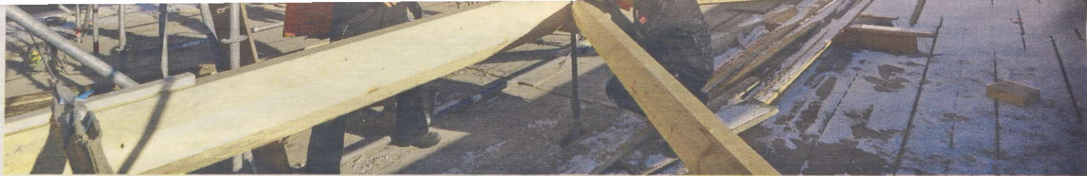
Medewerkers van de Norel Bouwgroep brengen de houten spanten op de juiste spanning. Foto: Ton Borsboom
